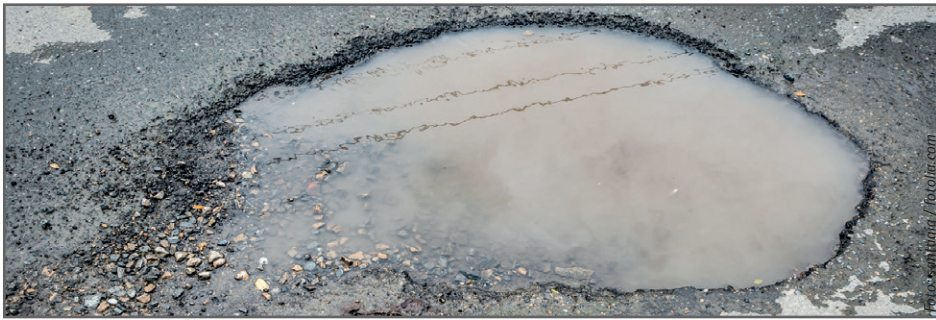
Kein ungewöhnliches Bild in Schleswig-Holstein: Straßen verfallen, die Infrastruktur leidet, notwendige Investitionen werden durch das Land nicht getätigt.
